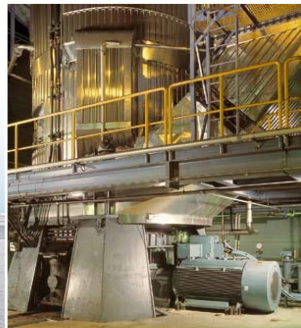
Электростанция Meri-Pori, двигатель угольной мельницы
